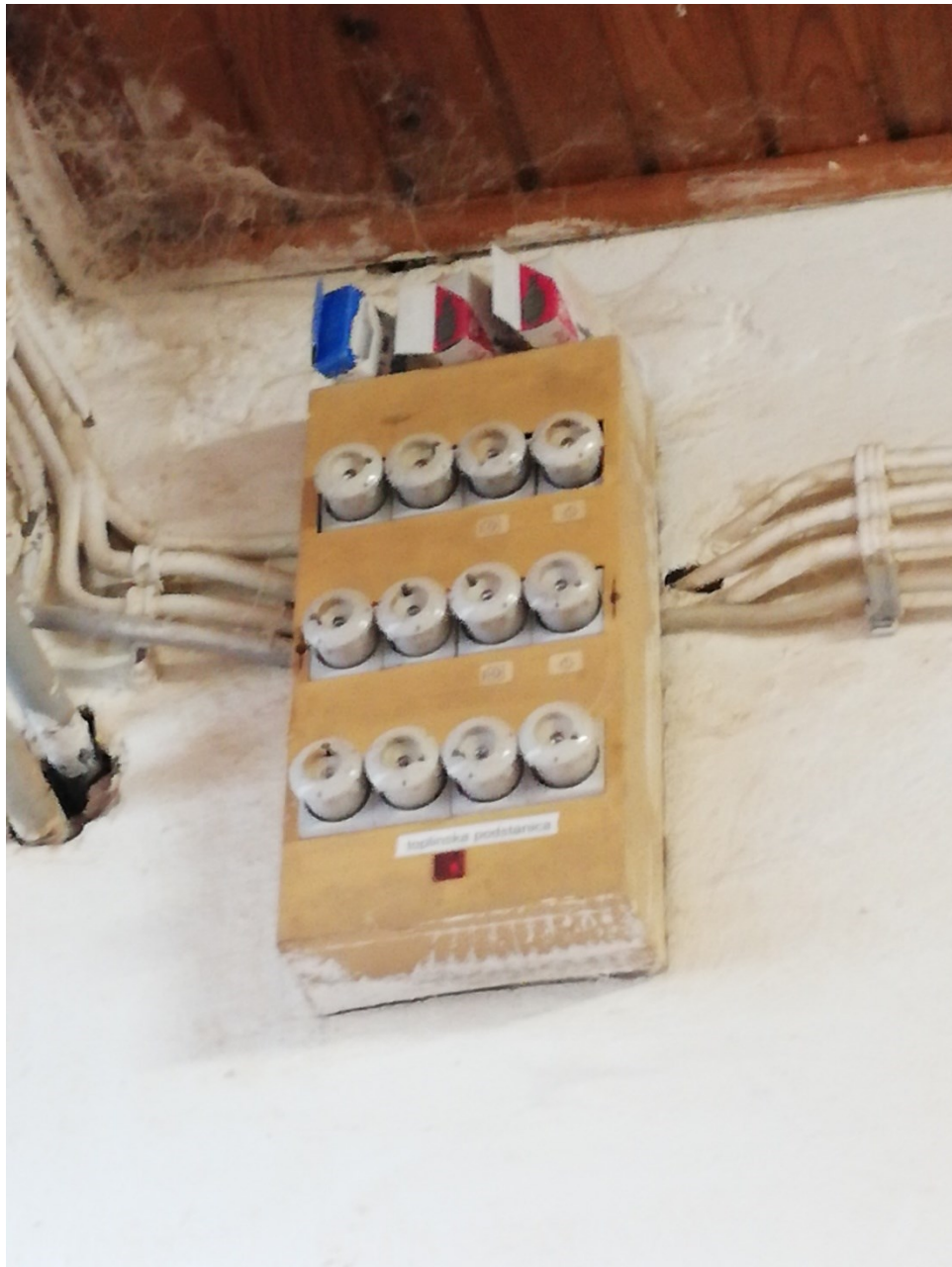
Slika 5.1. Razvodni ormar (fotografirano 3.6.2019.).
