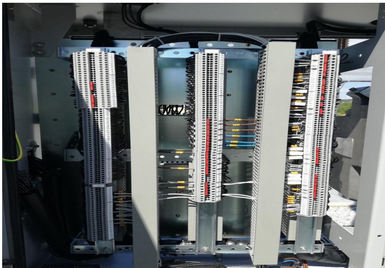
Slika 5.13. Redne stezaljke u ormaru prekidača
