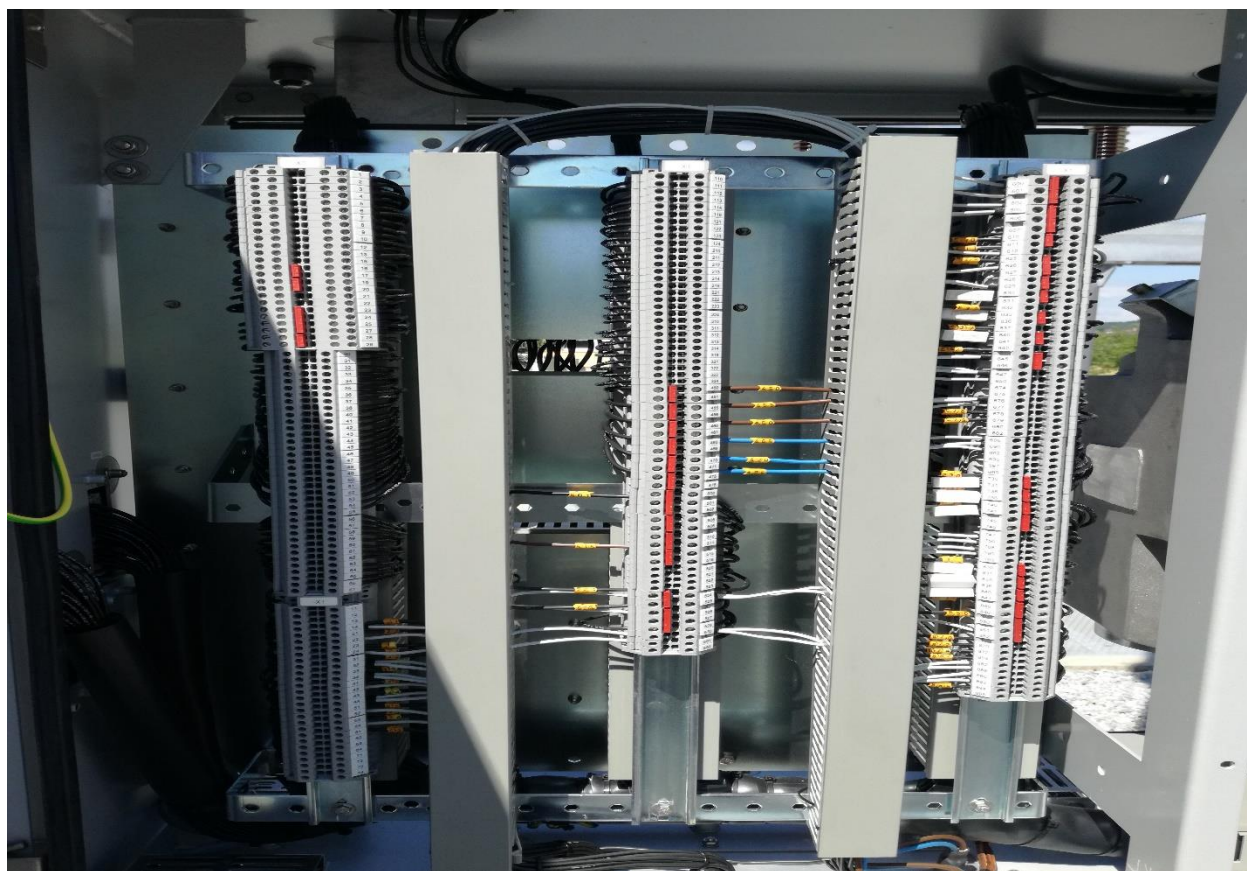
Slika 5.13. Redne stezaljke u ormaru prekidača
