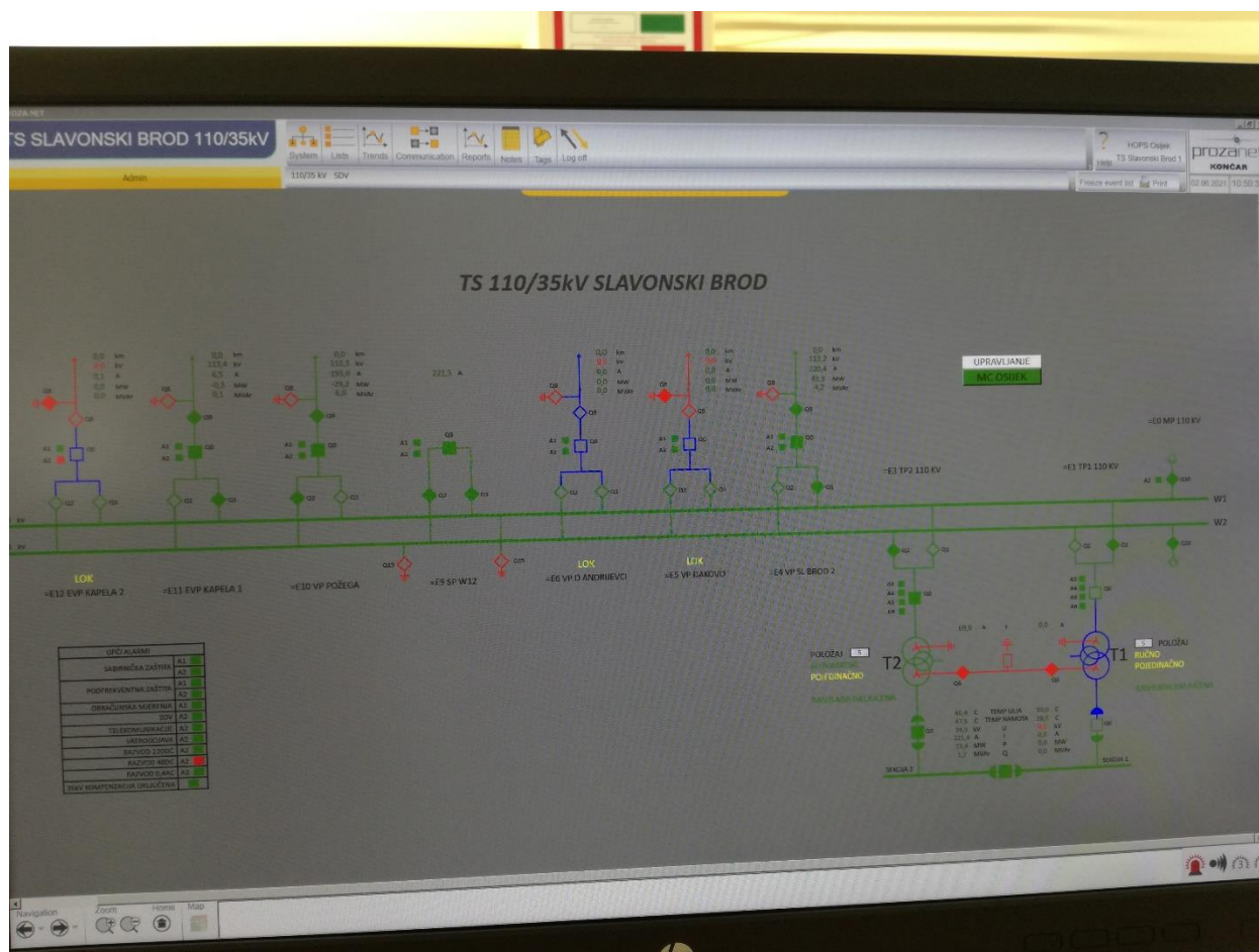
Slika 5.14. Signalizacija stanja aparata na staničnom računalu u TS 110/35 kV Slavonski brod
