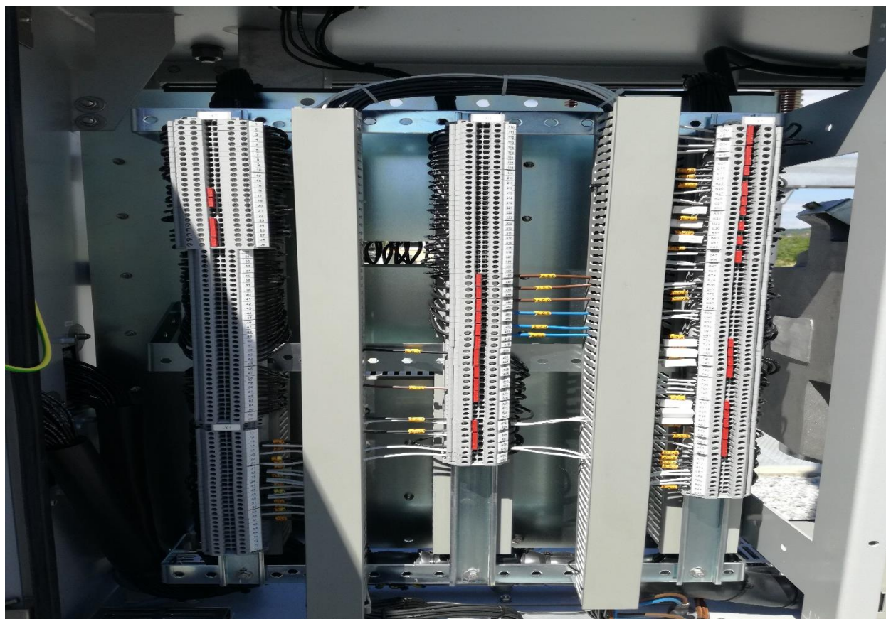
Slika 5.13. Redne stezaljke u ormaru prekidača
