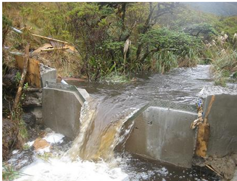
Slika 6.3.4. Trokutasti preljev na vodotoku [26]
