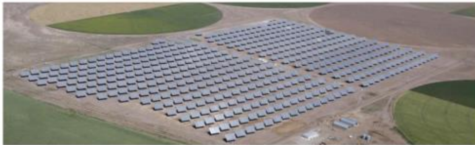
Slika 3.10. Koncentrirana fotonaponska elektrana snage 30MW u Alamosu u Sjedinjenim Američkim Državama [11]
