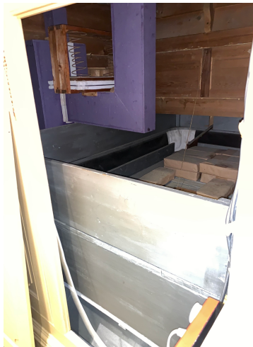
Slika P.1.3. Pogled u unutrašnjost orgulja sa zračnim kanalima i mjevovima
