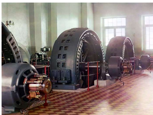
Slika 3.1 Električni generator u hidroelektrani [4]
