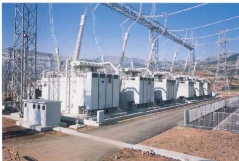
Slika 3.8. Jednofazni autotransformator 500 MVA [10].
