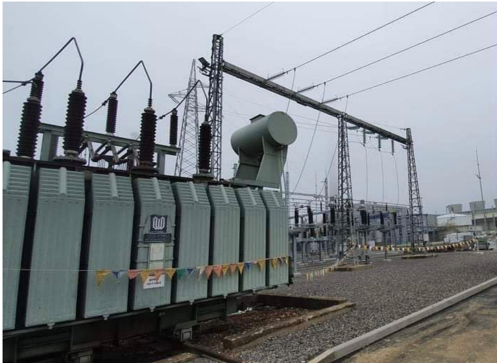
Slika 2.8. Transformator 10/110 kV i vodno polje
