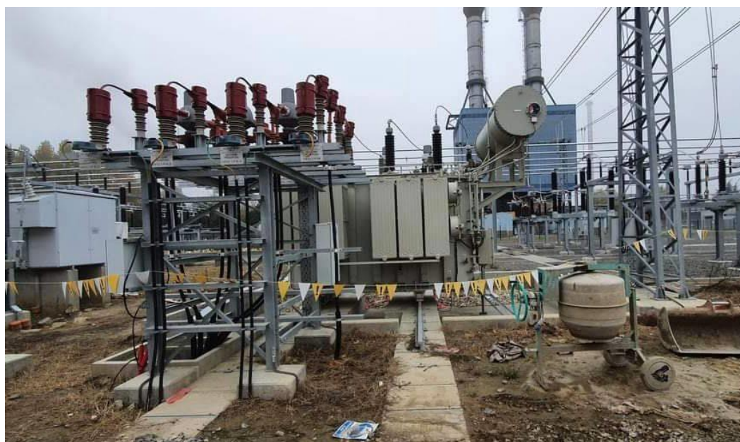
Slika 2.9. Trafo polje 35 kV
