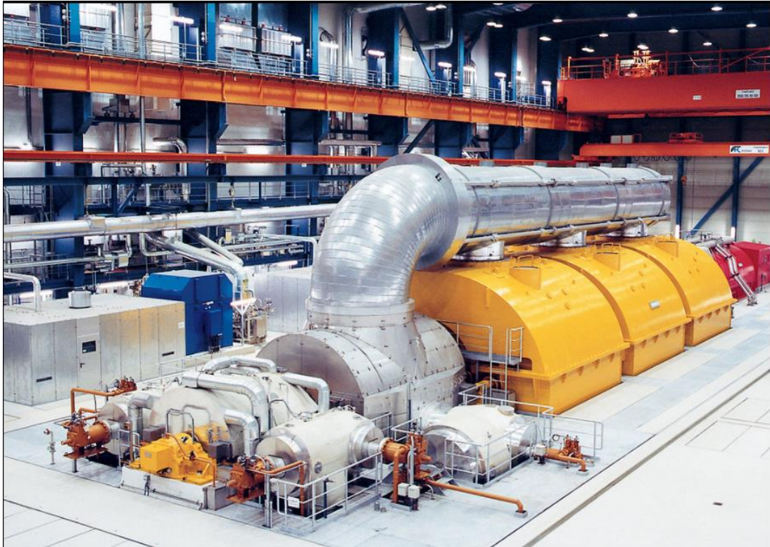
Slika 2.9. Turbogenerator tvrtke Siemens.[13]
