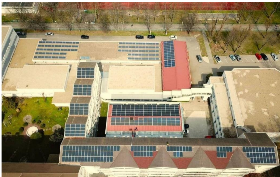
Slika 1.2. Fotonaponska elektrana u mikromreži FERIT 1
