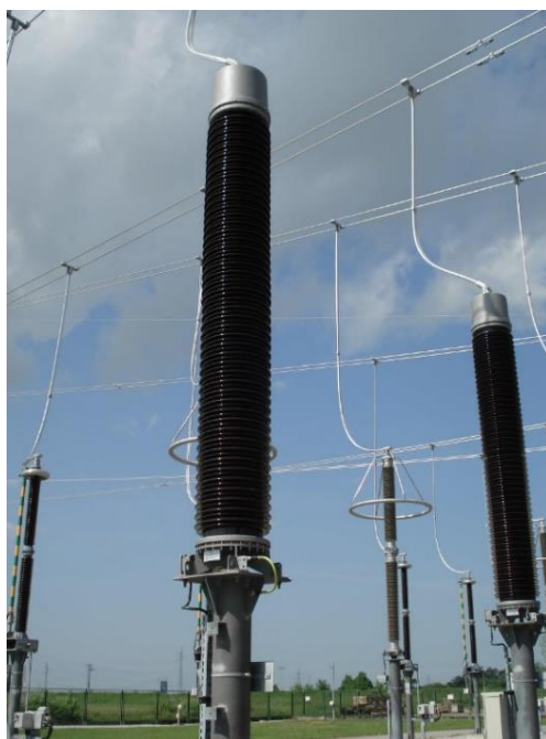
Slika 2.24. Uljni jednopolno izolirani naponski mjerni transformator [1]
