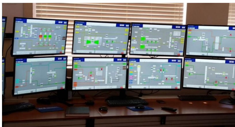
Sl. 4.17. Primjer kontrolne sobe.
