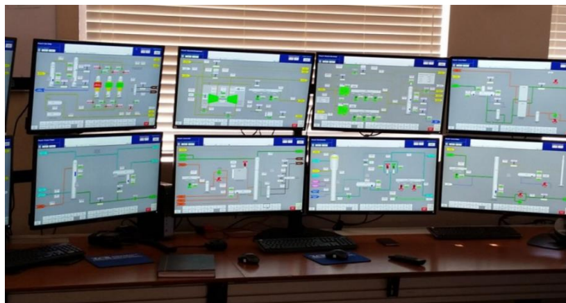
Sl. 4.17. Primjer kontrolne sobe.
