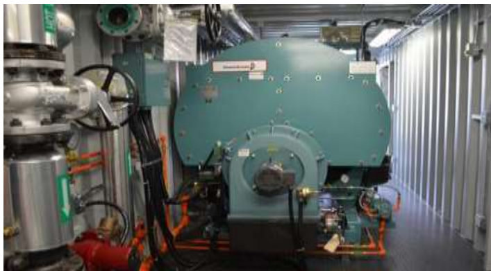
Slika 5.4. Plinska-blok kotlovnica u transportu, [25]
