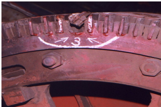
Slika 5.2. Oštećenje kaveznog rotora
