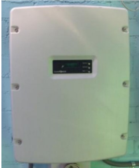
Slika 3.5. Izmjenjivač u fotonaponskom sustavu [11]
