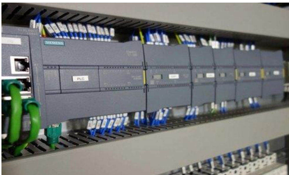
Slika 3.1.: PLC u upravljačkom ormaru
