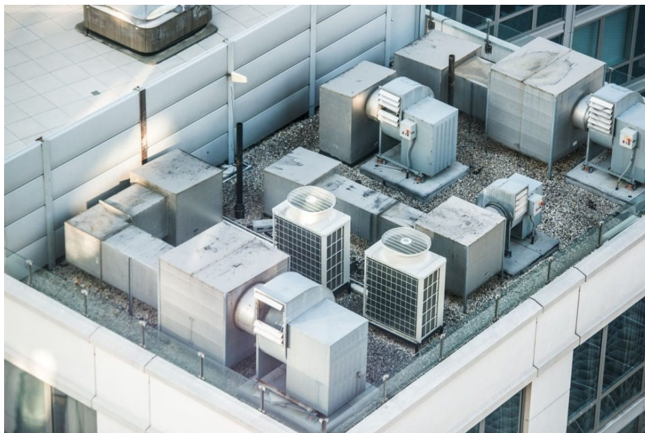
Slika 3.3.3. Prikaz HVAC sustava na krovu zgrade
