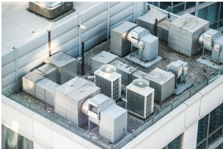
Slika 3.3.3. Prikaz HVAC sustava na krovu zgrade
