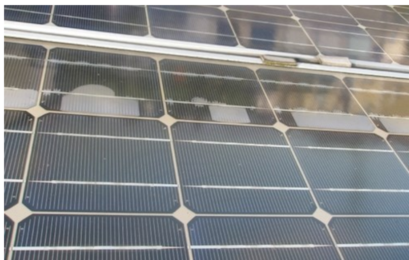
Slika 4.2. Delaminacija c-Si modula [19]
