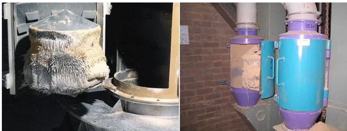
Slika 5.2. Magnetski bullet separatori u postrojenjima [11]
