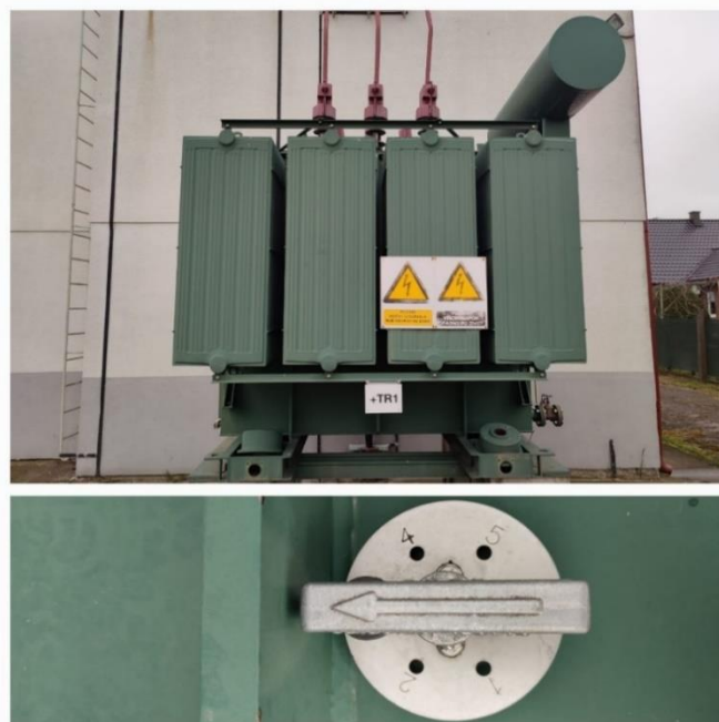
Slika 3.4. Distributivni transformator s ručnom preklopkom (35/10 kV) nazivne snage 8000 kVA te njegova ručna preklopka.
