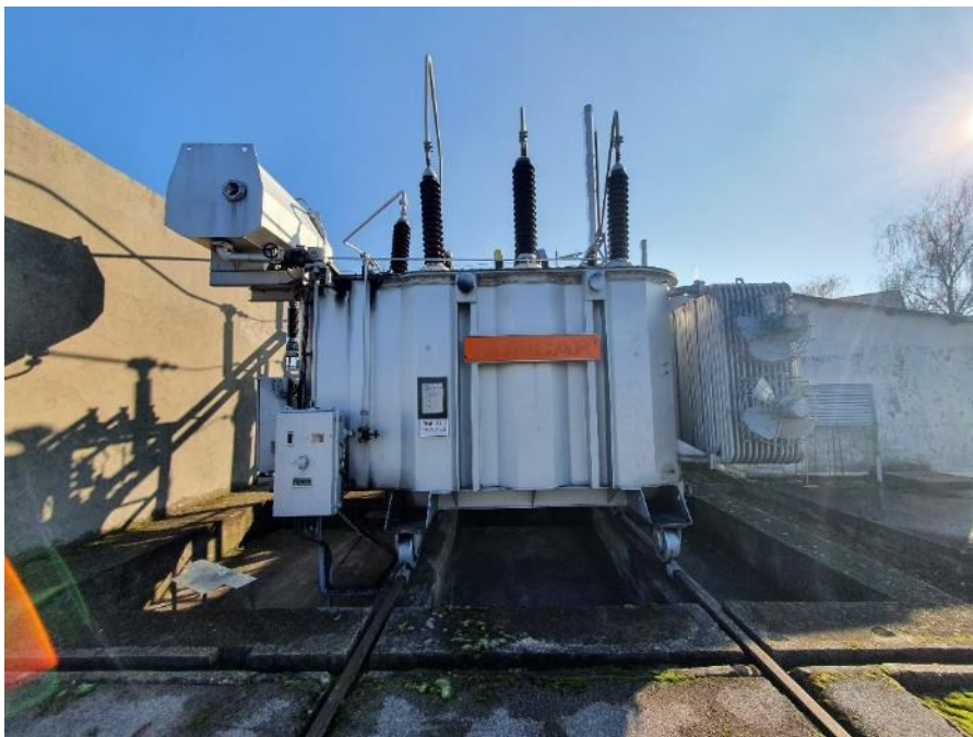
Slika 5.8. Transformator (fotografirano 24. studenog 2021.)
