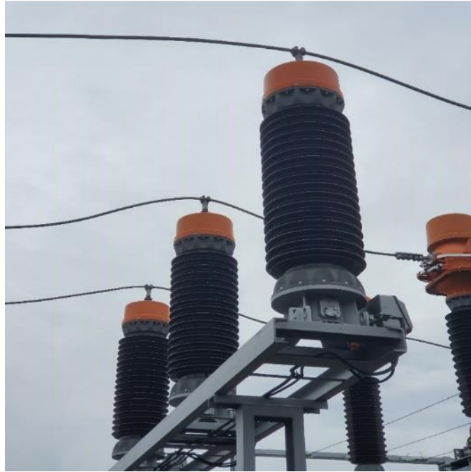
Slika 5.4. Naponski mjerni transformatori (fotografirano 9. kolovoza 2022.)
