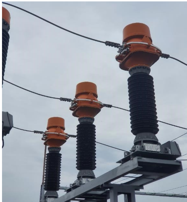
Slika 5.5. Strujni mjerni transformatori (fotografirano 9. kolovoza 2022.)
