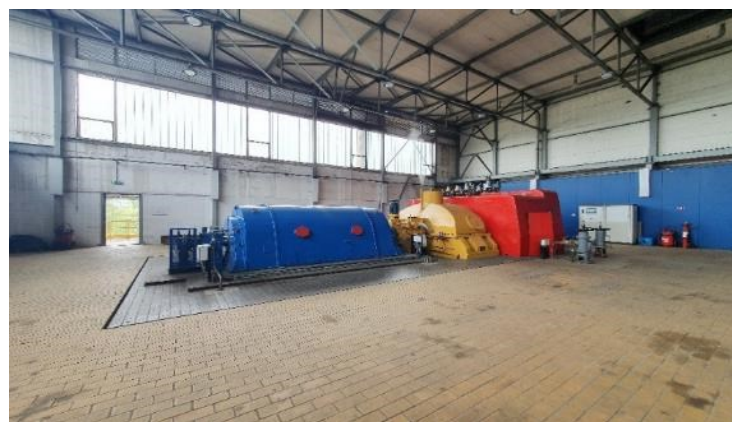
Slika 5.11. Generator 3 Rade Končar (fotografirano 9. kolovoza 2022.)
