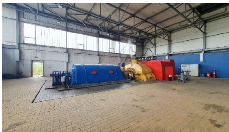
Slika 5.11. Generator 3 Rade Končar (fotografirano 9. kolovoza 2022.)
