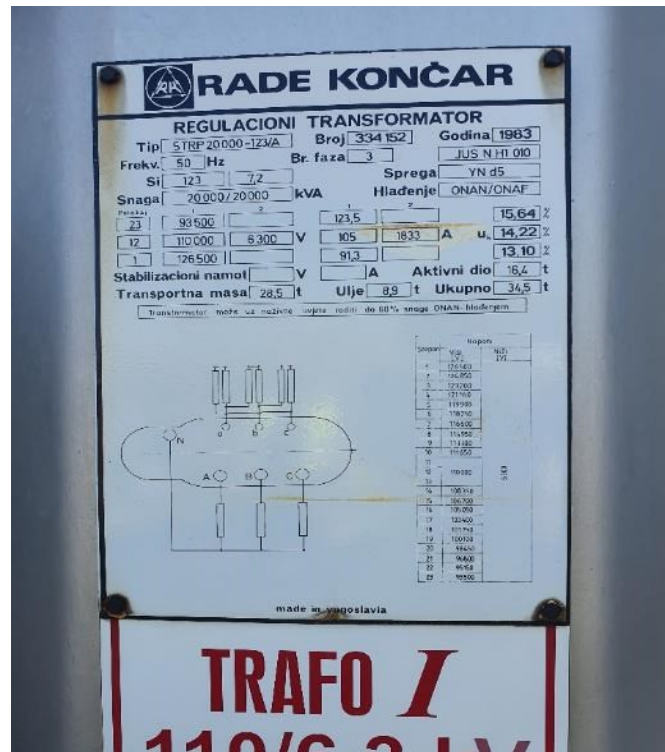
Slika 5.9. Natpisna pločica energetskog transformatora (fotografirano 13. travnja 2022.)
