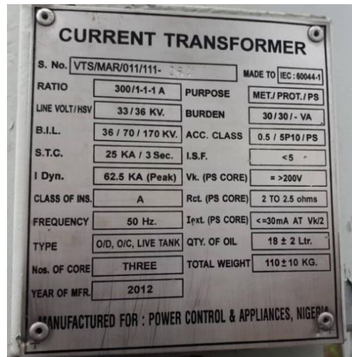
Sl. 4.10 . Natpisna pločica strujnog mjernog transformatora. [19]
