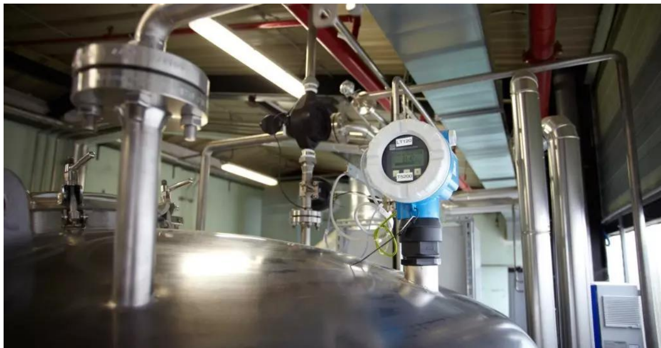
Slika 7.3. Prosonic FMU44 montiran u postrojenju
