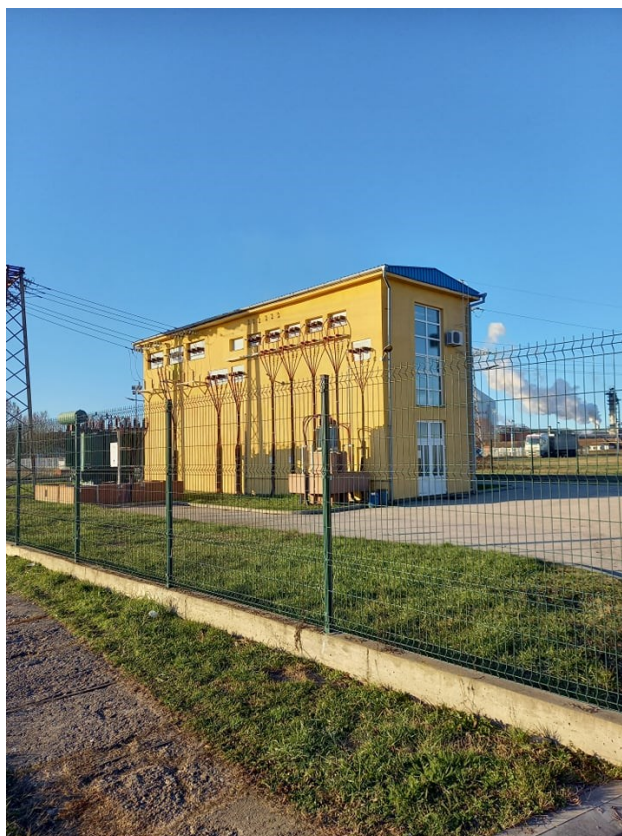
Slika 2.2. Distributivna trafostanica 35/10 kV ŽUPANJA 1
