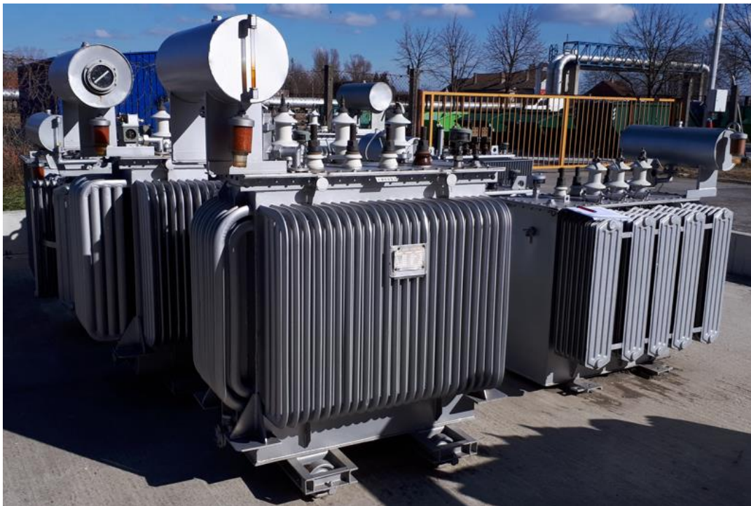
Sl. 3.12. Prikaz uljnih distribucijskih transformatora
