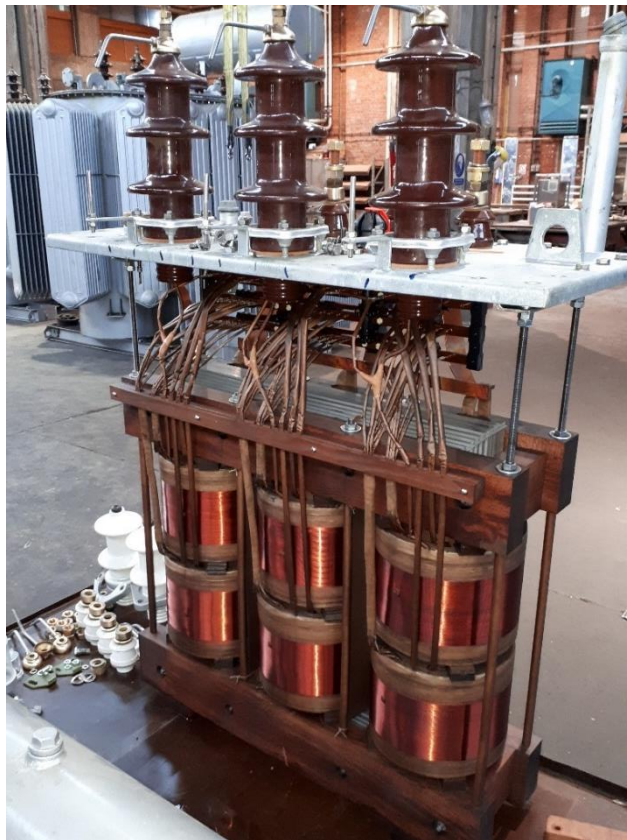
Sl. 3.11. Prikaz unutrašnjosti distributivnog transformatora
