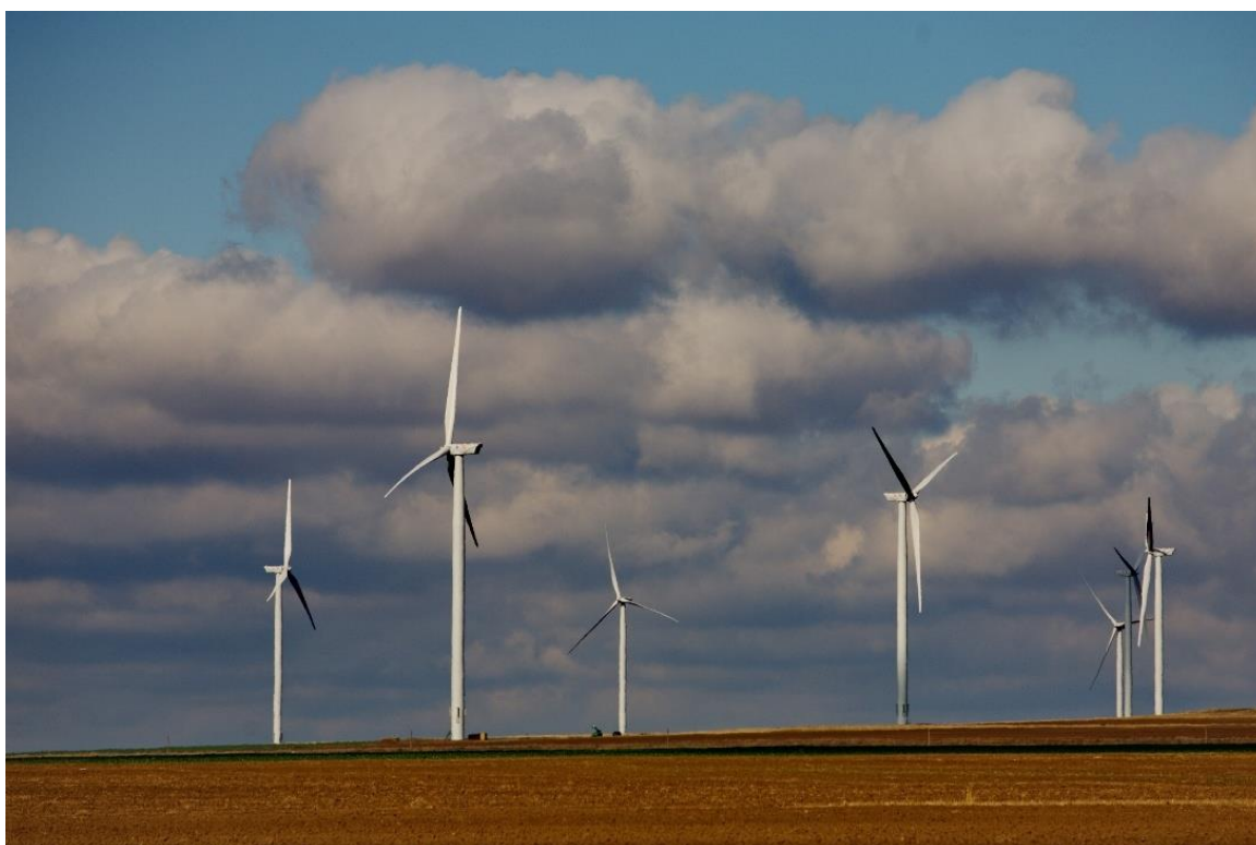
Sl. 4.10. Primjer vjetroelektrane instalirane na kopnu [19]
