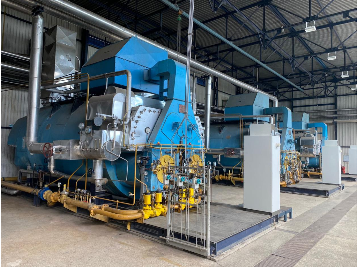
Slika 3.2. Prikaz steamblok kotlovnice (fotografirano 8.lipnja 2022.)
