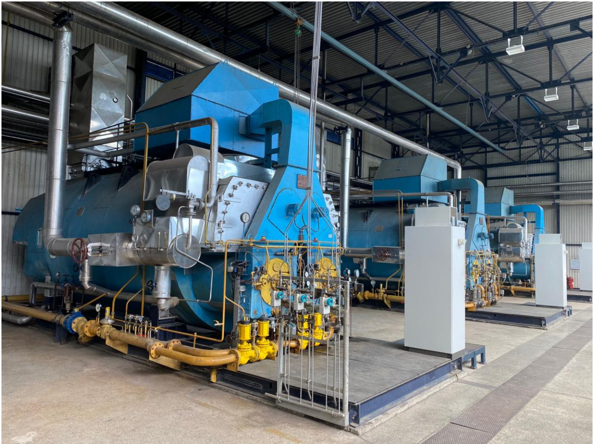
Slika 3.2. Prikaz steamblok kotlovnice (fotografirano 8.lipnja 2022.)
