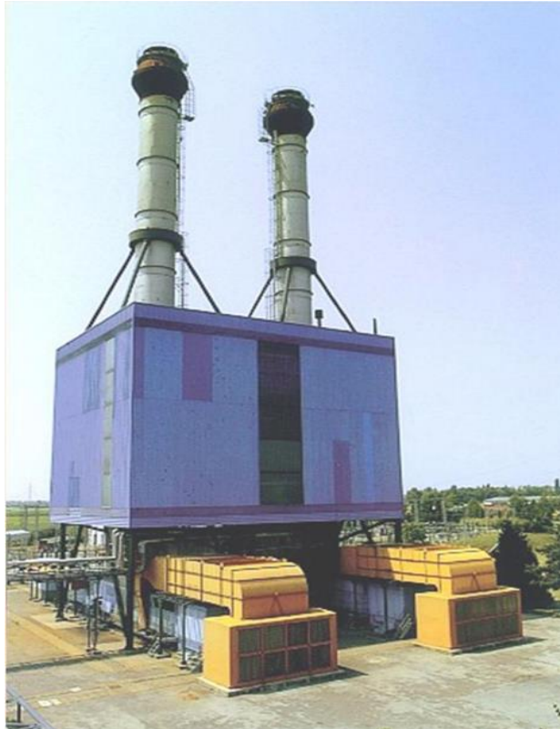
Slika 2.2. Plinsko turbinska elektrana [1]
