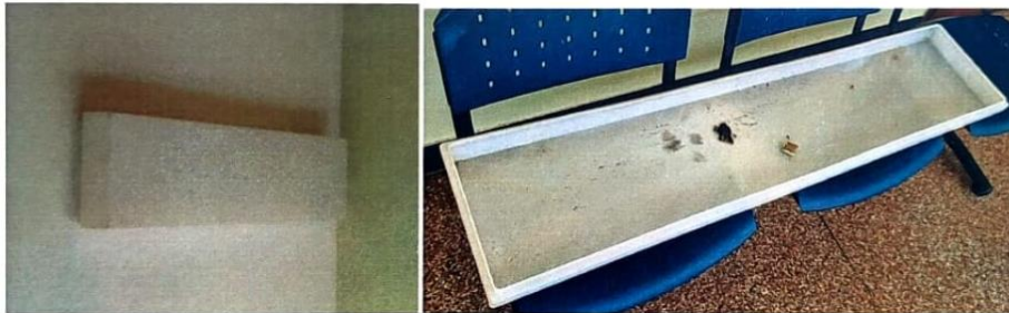
Slika 5.4. Difuzor rasvjetnog tijela i komadi plastičnog kućišta prigušnice uočeni termografskom analizom
