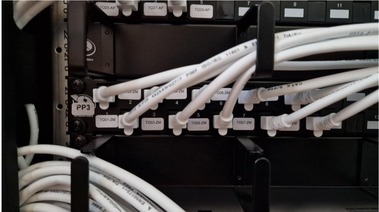
Slika 3.1 Primjer označavanja utičnica na prespojnom panelu
