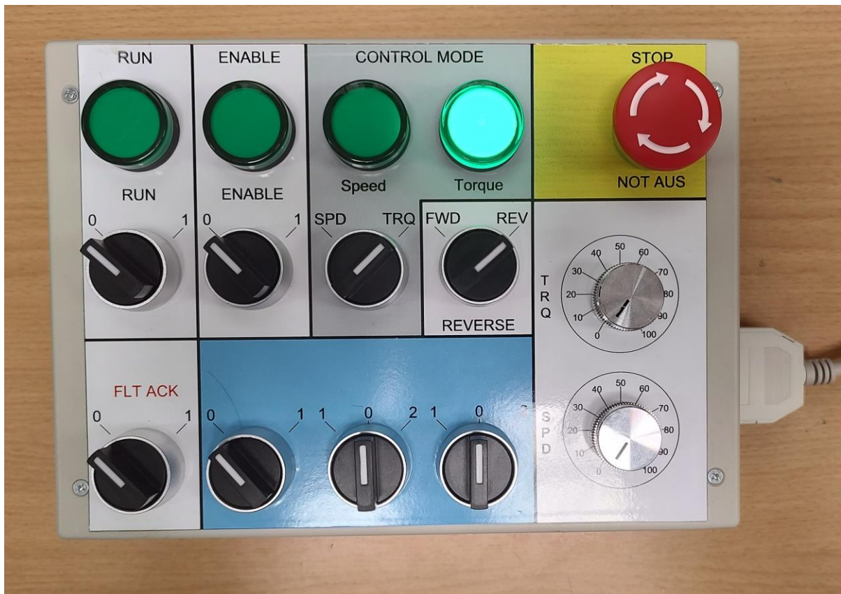
Slika 5.30: Lokalni upravljački panel
