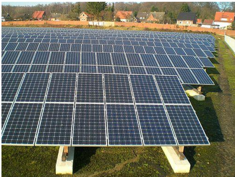
Slika 3.1. Prikaz fotonaponske elektrane s fiksnim položajem [10]
