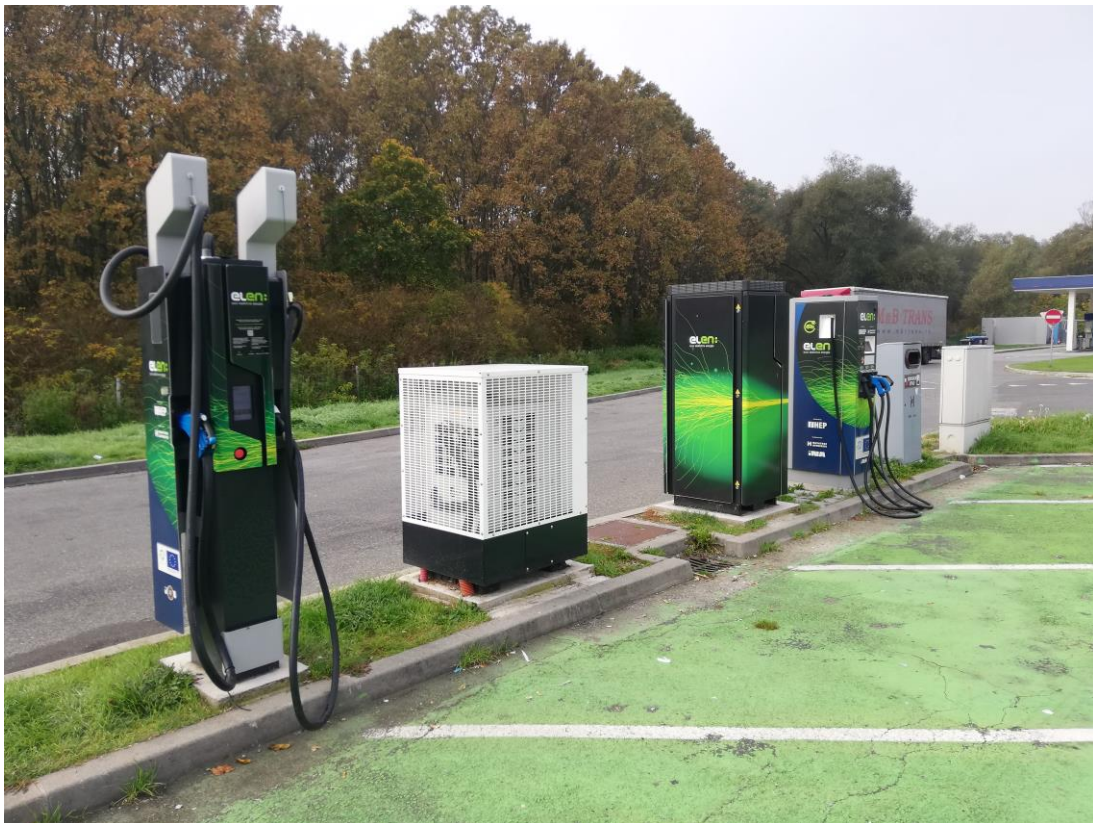
Sl. 4.1. Punionice za električna vozila na odmoru Novska
