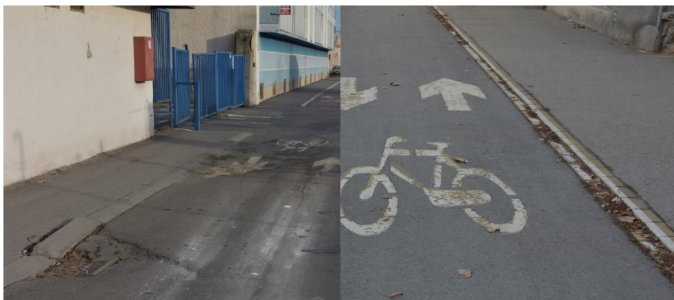
Slika 5.8. Oštećenja i razgraničenje pješačke i biciklističke staze
