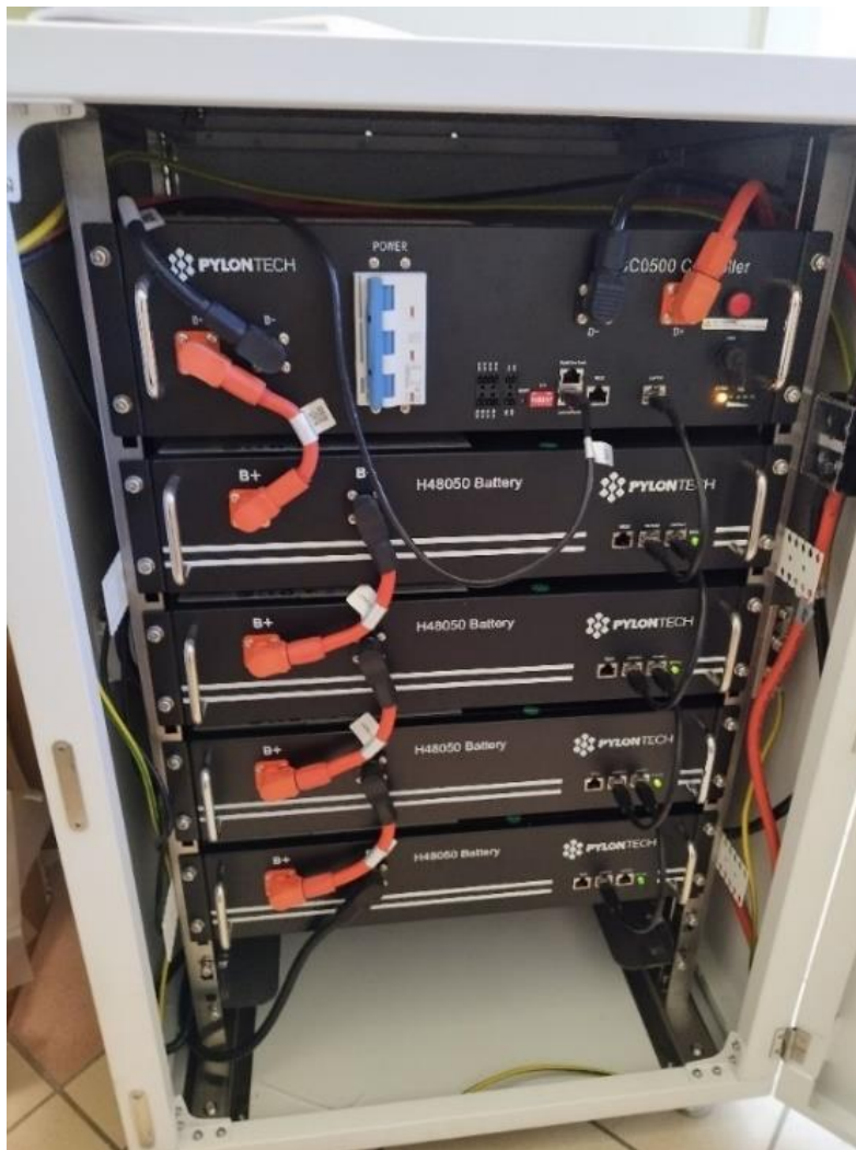
Slika 5.8. Upravljač baterijskog sustava PylonTech SC0500 s paketom baterija H48050
