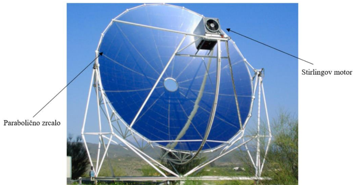
Sl. 7.1. Slika solarne termoelektrane s tanjurastim kolektorom[23].
