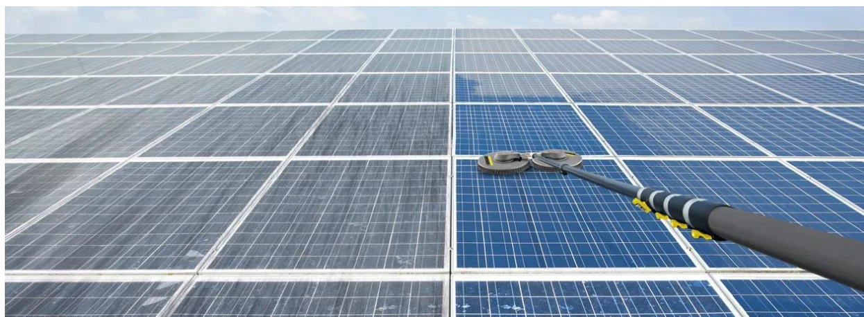
Slika 4.3.1. Održavanje solarnih panela [16]
