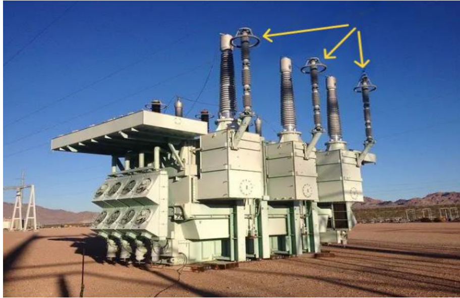
Slika 4.2. Odvodnici prenapona na trofaznom energetskom transformatoru [21]
