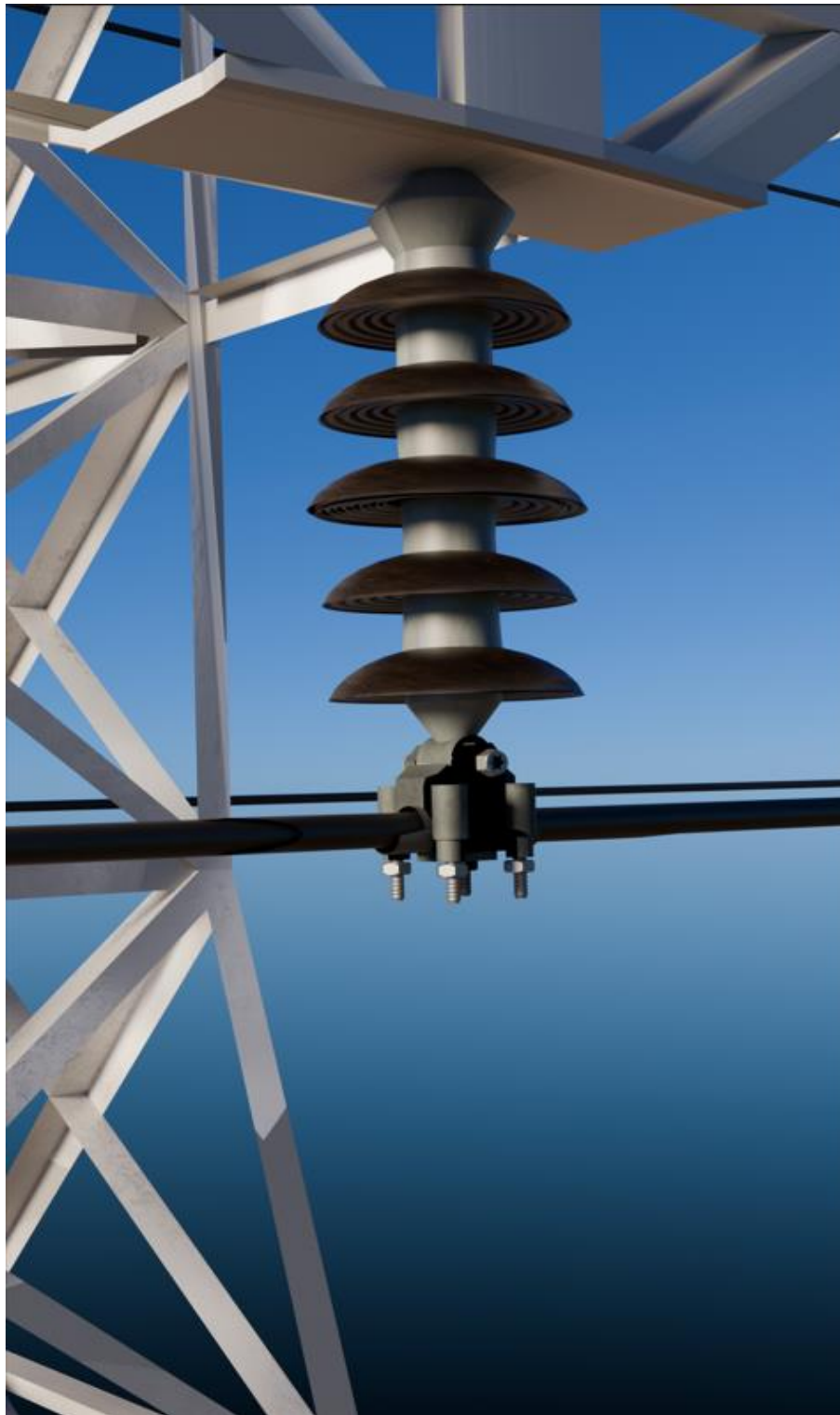
Slika 5.4. Prikaz detalja visećeg izolatora i visokonaponskog kabla
