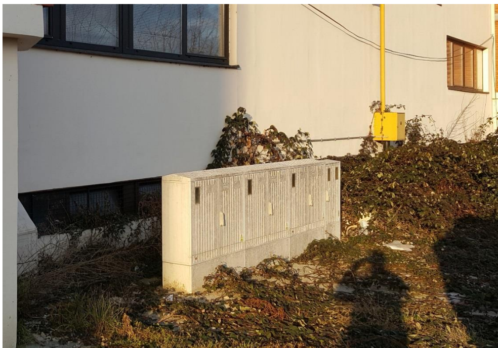
Slika 4.1. Samostojeći mjerni razvodni ormari [2]
