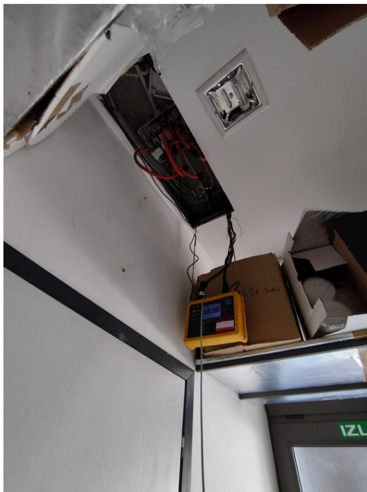
Slika 4.4 Mjerenja prvobitnog rasporeda trošila.
