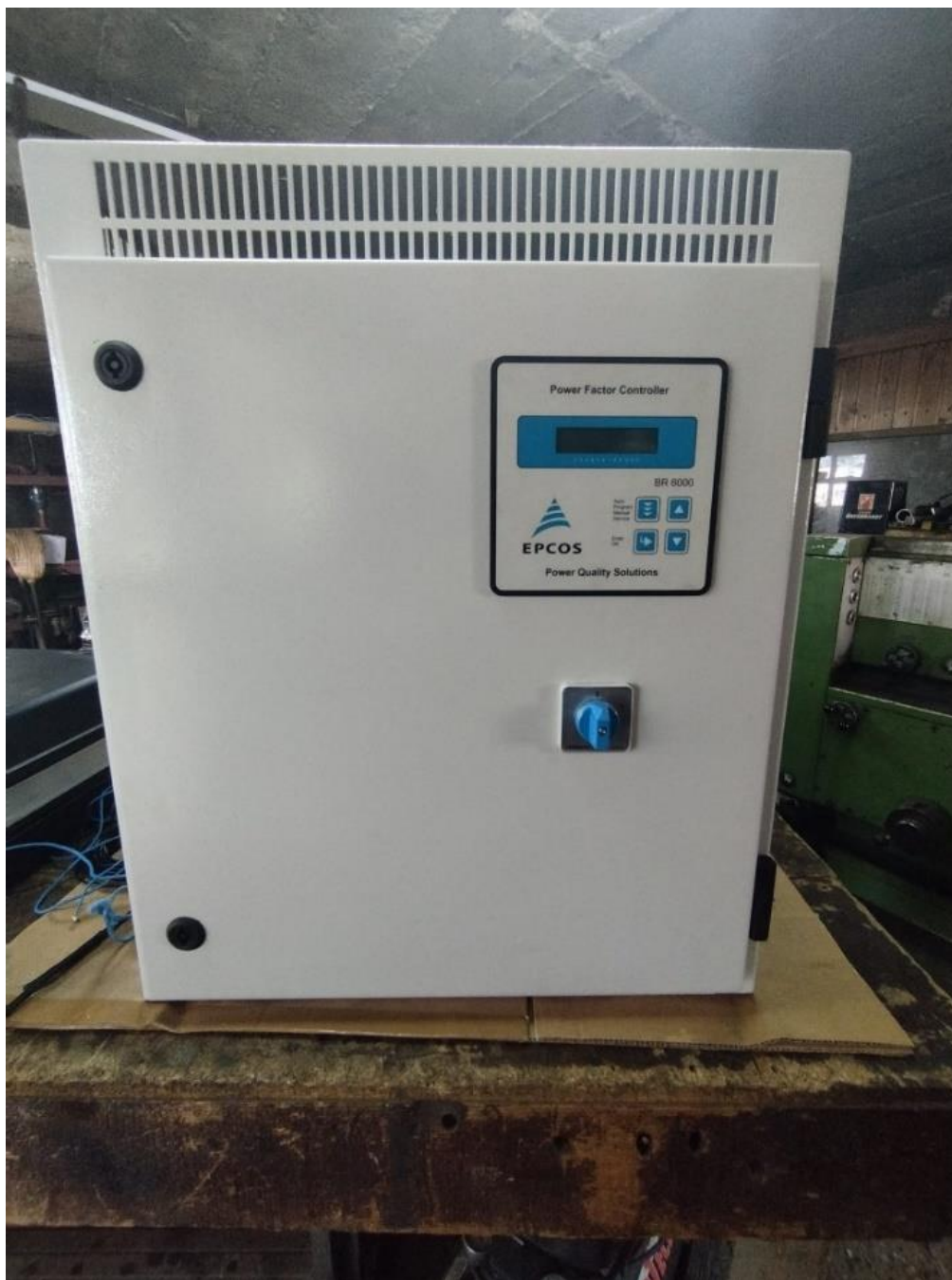
Slika 4.9 Uređen ormar sa ugrađenim uređajem EPCOS BR6000.
