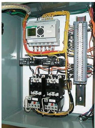
SI. 3.2. PLC kontrolni panel [4]
