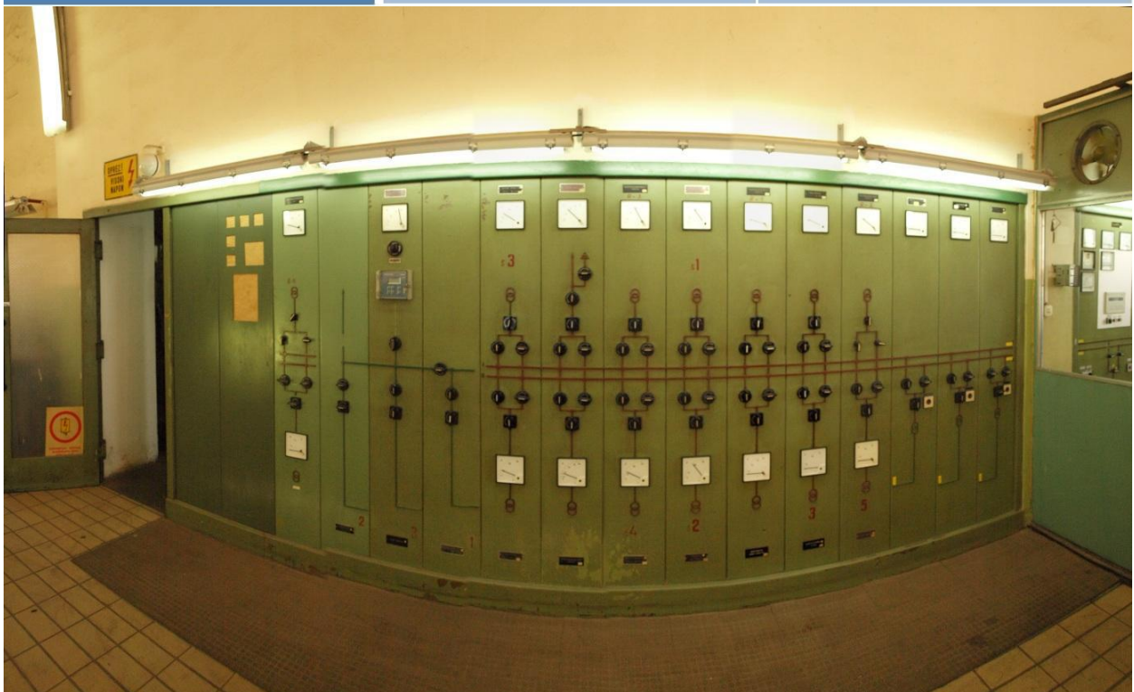
Slika 5.2. Uklopnicu u energiji (komandna ploča na kojoj su prikazana stanja svih transformatora u pogonu i na kojoj je moguće pratiti i trenutnu potrošnju na istim transformatorima)
