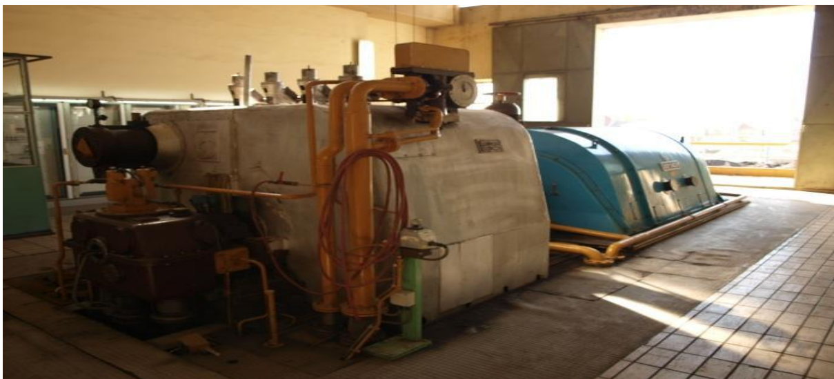
Slika 3.7. Turbina 10 MW u Tvornici šećera Osijek
