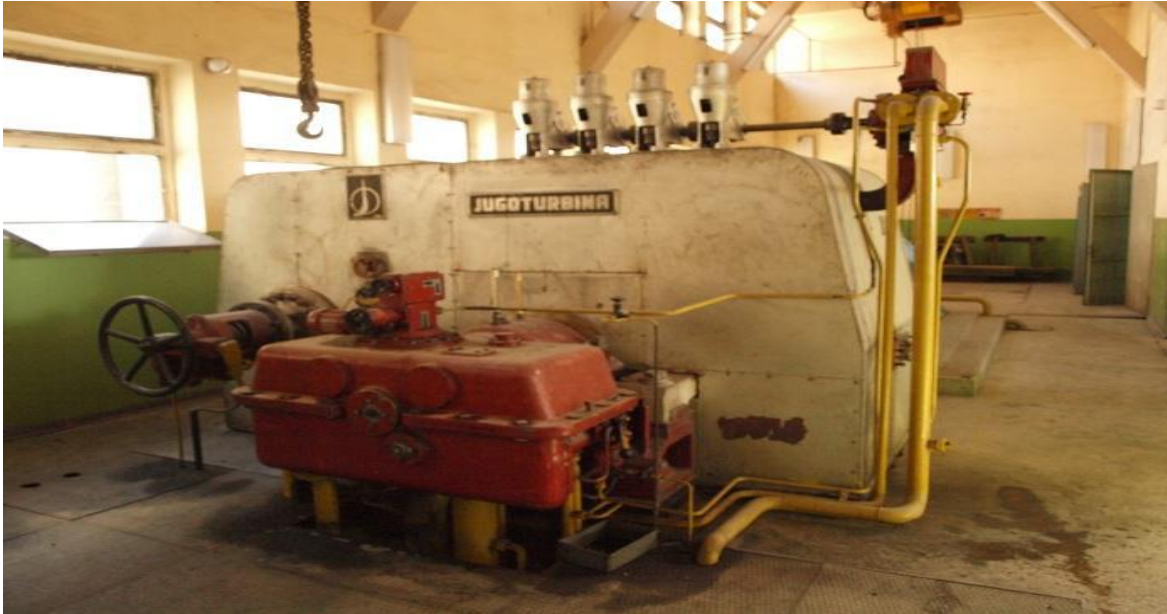
Slika 3.4. Turbina 6 MW u Tvornici šećera Osijek
