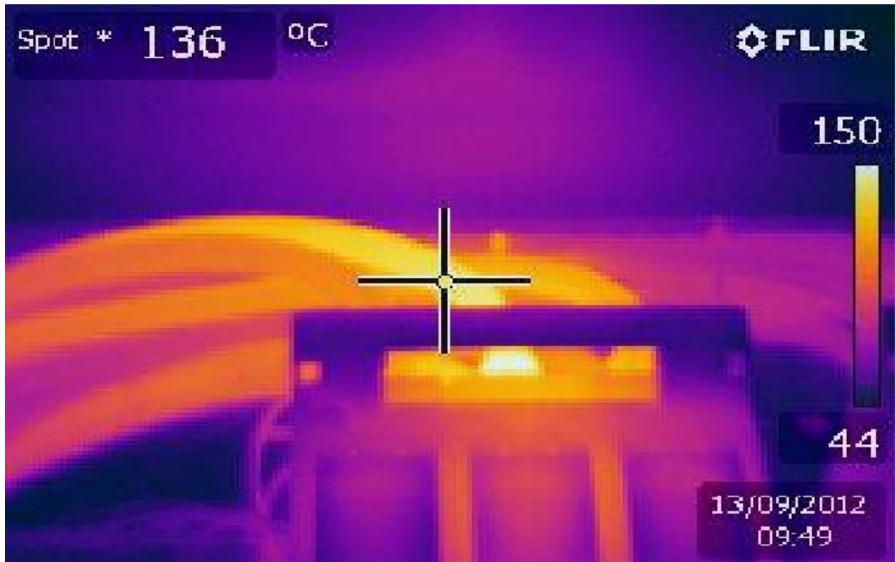
Slika 8.1. Snimka termovizijskom kamerom. Snimke se koriste za popravke u razdoblju remonta pogona
