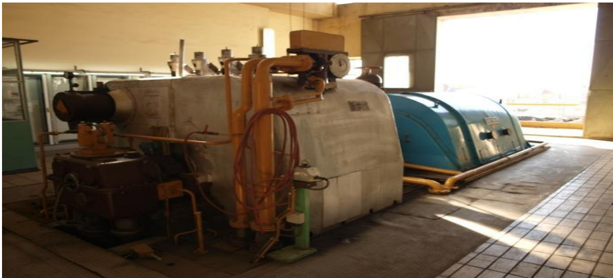
Slika 3.7. Turbina 10 MW u Tvornici šećera Osijek
