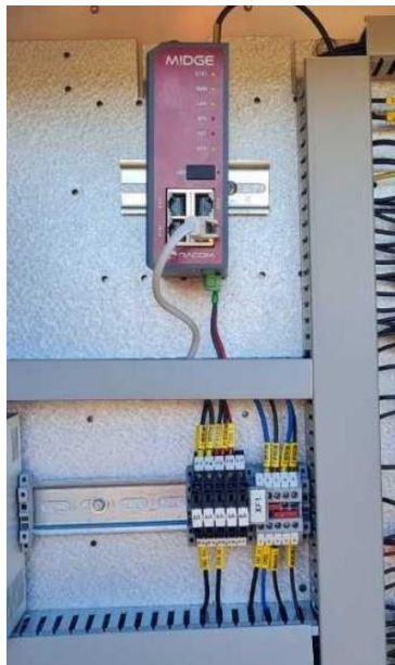
Slika 5-7 Primjer ugradnje GPRS-a u upravljački ormarić
