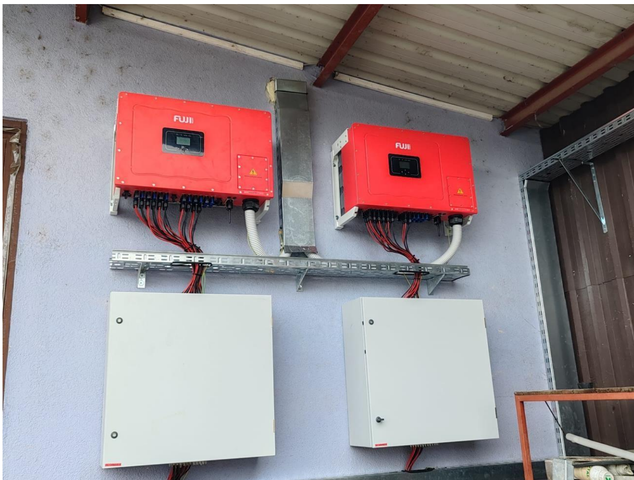
Slika 4.5 Prikaz invertera i DC ormara
