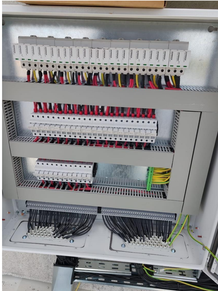
Slika 4.6 Prikaz DC ormara
