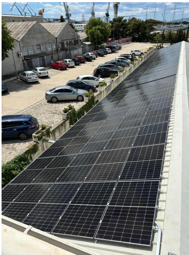
Slika 4.2 Prikaz instaliranih fotonaponskih modula
